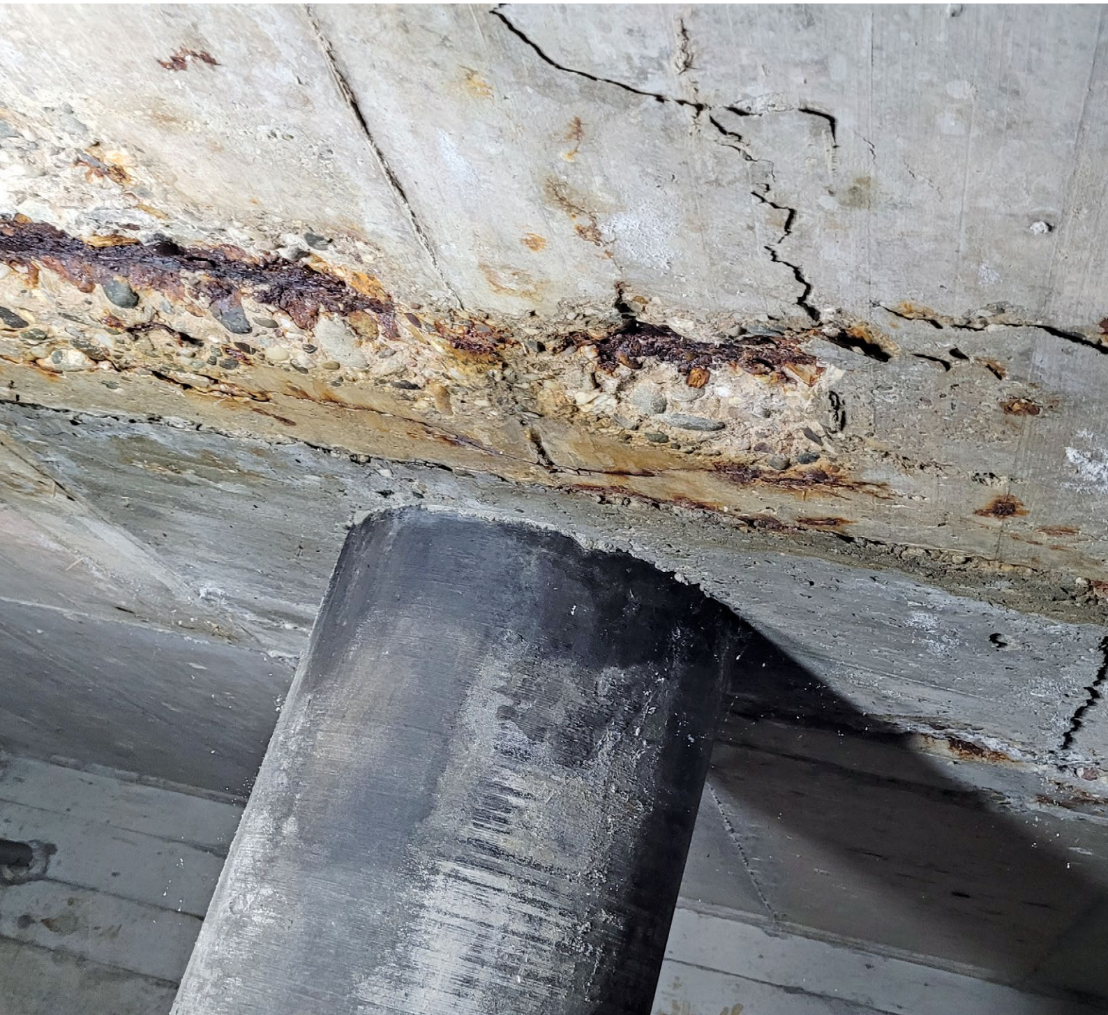
Abbildung 1.1: Schäden an B10 Enzbrücke in Enzweihingen (Quelle: Ministerium für Verkehr Baden-Württemberg)
