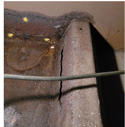
Abbildung 1.2: Schäden an B 10 Stahlbrücke in S-Zuffenhausen (Quelle: Ministerium für Verkehr)
